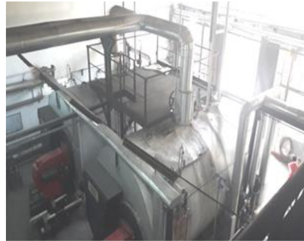
Kotlovi sa plamenicima ugrađeni u posmatranom pogonu
