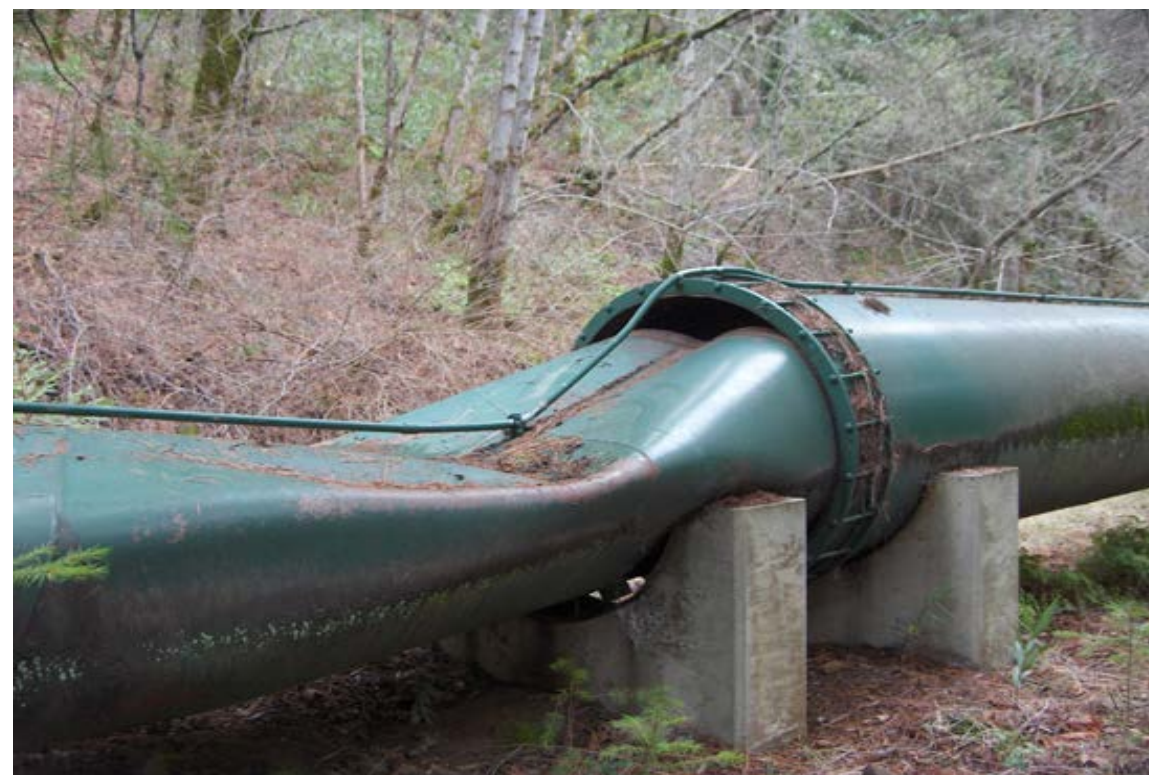
Slika 3. Lom usled izvijanja cevovoda
